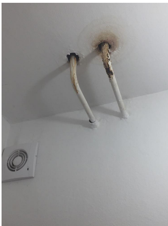
*fűtővíz csepegés, rozsdás csövek,
